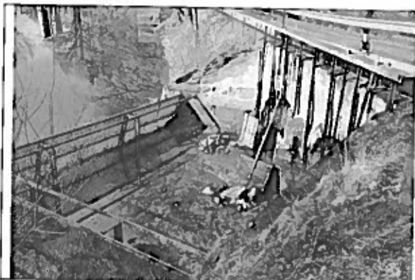
Poškozený objekt a část hráze po povodni 2013 na Janovickém potoce nad školicím střediskem KB – rybník Libohošťský.
